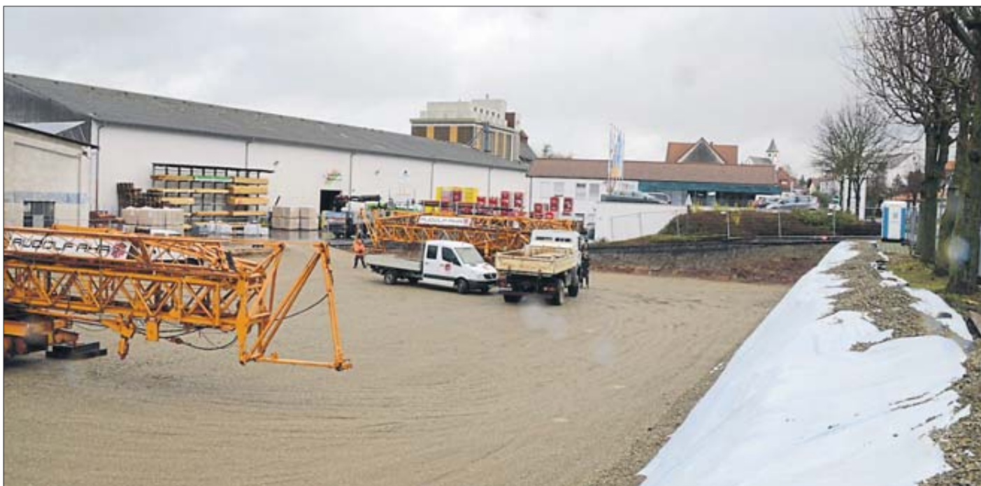
An der Fuldaer Straße gegenüber der Aral-Tankstelle entsteht bis zum Mai die rund 1200 Quadratmeter große Lagerhalle der Raiffeisen Baustoff-Niederlassung. Foto: Hartmut Zimmermann
